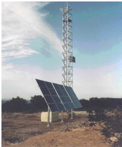
FIGURA 2 –Estação de telecomunicação alimentada por sistema fotovoltaico
