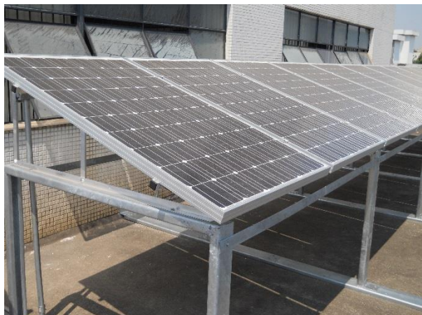
Gerador fotovoltaico conectado à rede -Belo Horizonte – MG
