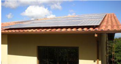
Gerador fotovoltaico conectado à rede Belo Horizonte – MG - Foto ilustrativa
