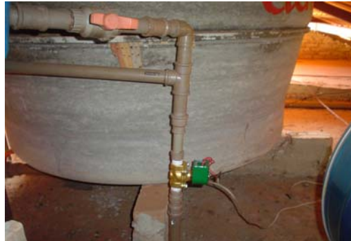
Foto 4.2– Válvula solenóide instalada
