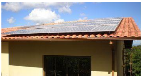
Gerador fotovoltaico conectado à rede Belo Horizonte – MG - Foto ilustrativa
