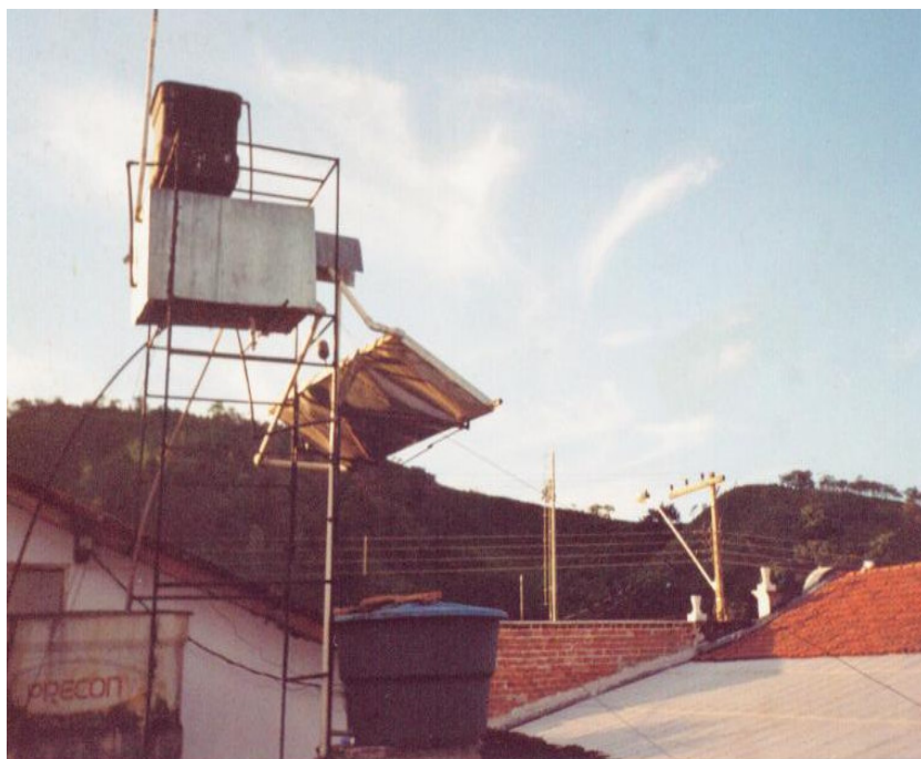
Imagem 1-Sistema de aquecimento solar instalado no domicílio (vista lateral)
