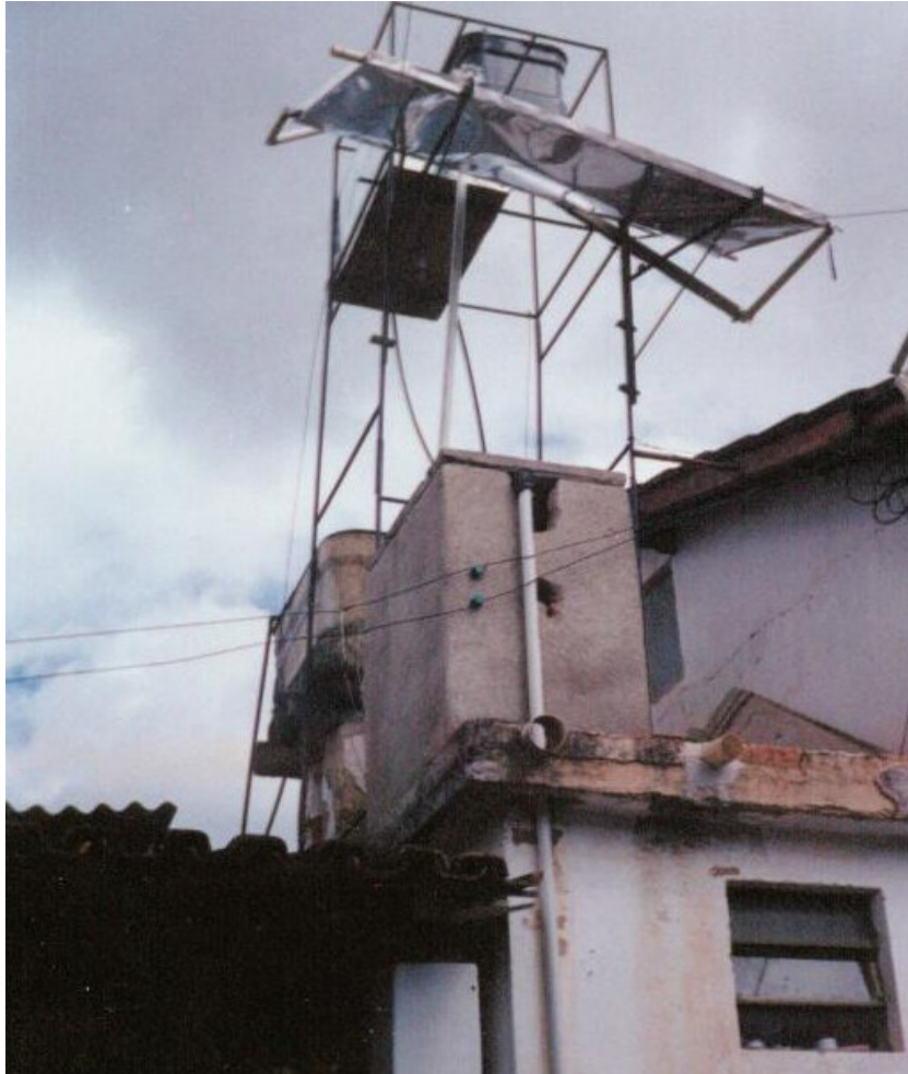
Imagem 3 - Sistema de aquecimento solar instalado no domicílio
