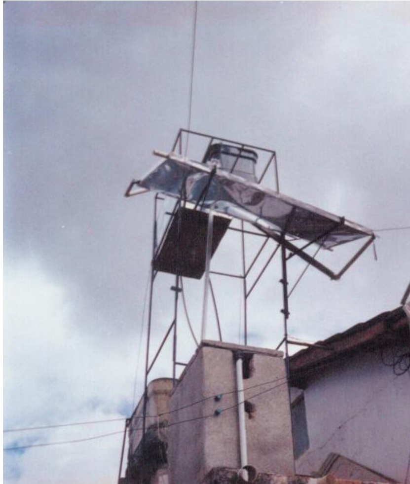
Imagem 2 - Sistema de aquecimento solar instalado no domicílio
