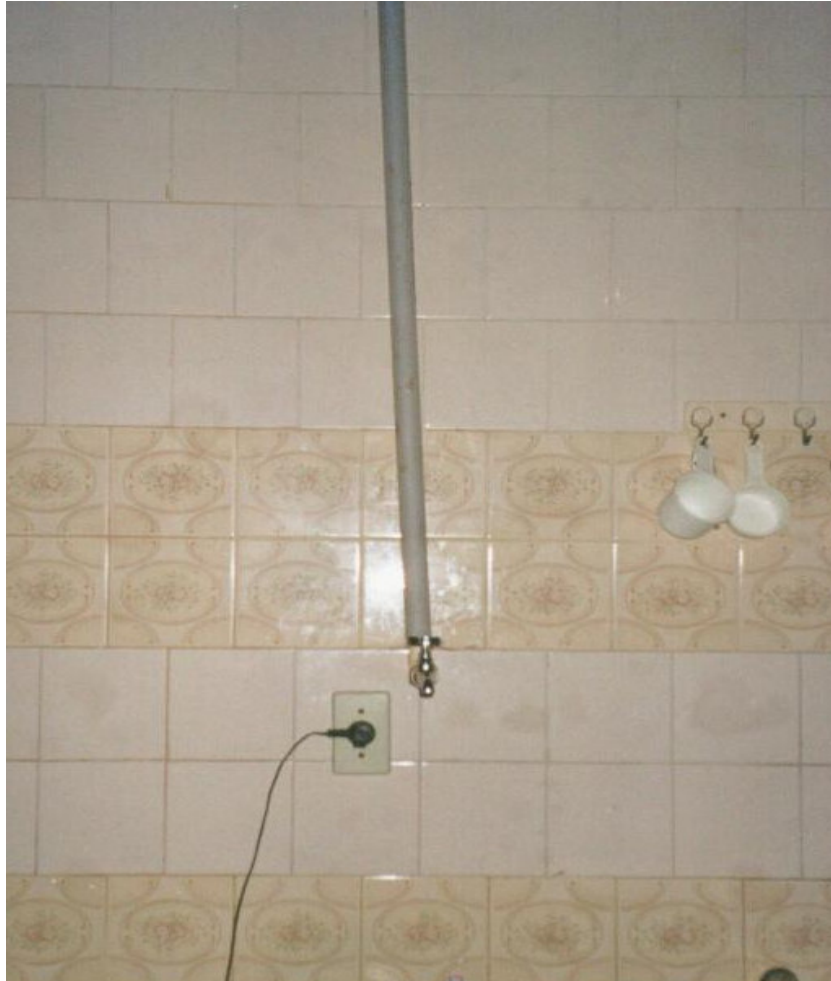
Imagem 5 - Torneira da cozinha que utiliza a água aquecida
