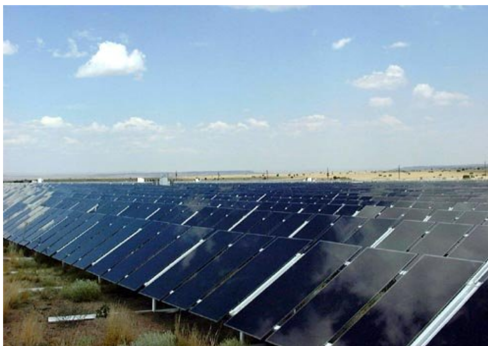
Figura 18– Instalação fotovoltaica de filmes finos (CdTe) em Dimbach, Alemanha (Fonte: National Renewable Energy Laboratory (NREL) ( www.nrel.gov ))
